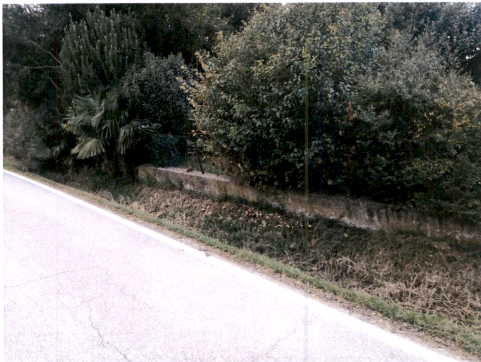
PARTICOLARE RECINZIONE DANNEGGIATA SU FRONTE STRADA
