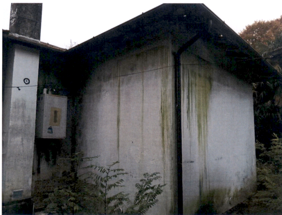
PARTICOLARE CALDAIA MURALE A GAS METANO SU FRONTE NORD
