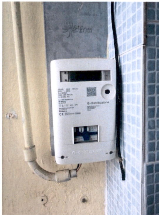
CONTATORE ENEL POSIZIONATO SU "BUSSOLA" INGRESSO
