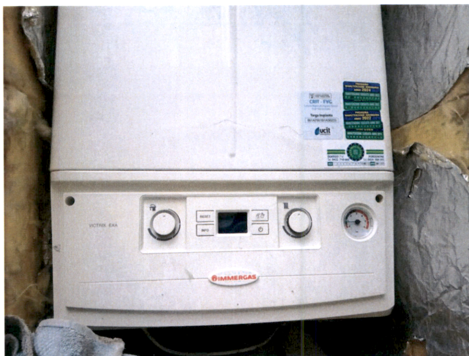
PARTICOLARE CALDAIA MURALE A GAS METANO
