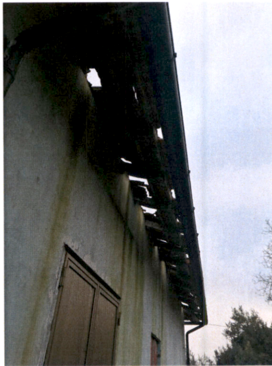
PARTICOLARE SPORCO DI LINDA CON MANTO DI COPERTURA DANNEGGIATO DALLA GRANDINE – ESTATE 2023
